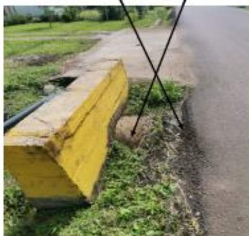
Ilustración N° 4 relleno superficial, tubo expuesto.
