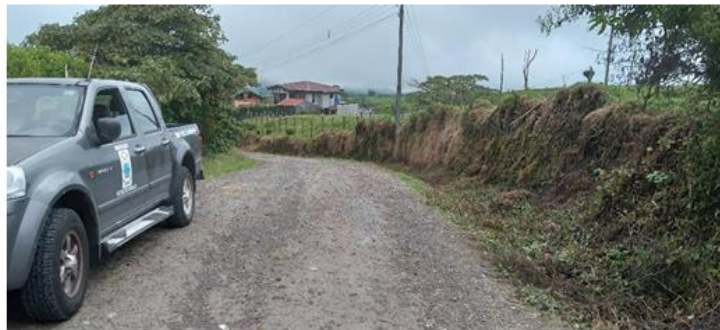
Ilustración 1 Condición actual de la calzada
