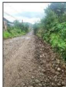
Material de tamaño superior acumulado en cunetas
