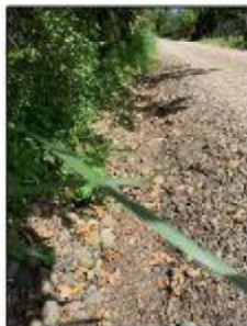
Material de tamaño superior acumulado en cunetas
