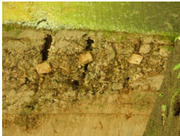
Figura 6-16 Refuerzo expuesto (grado 5)
