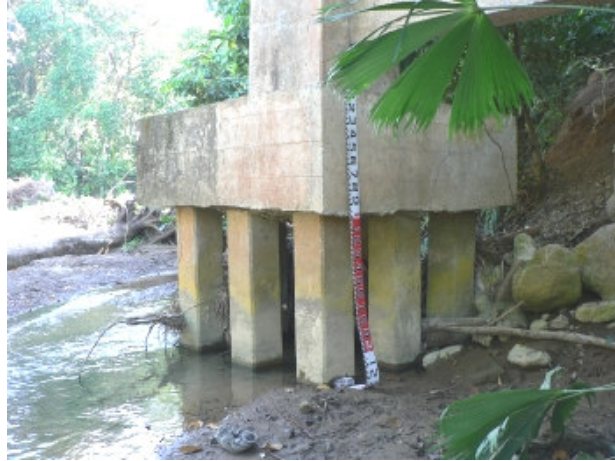
Figura 6-42 Socavación en la fundación (grado 5)
