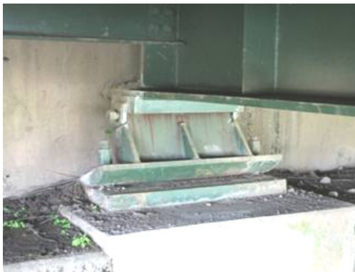
Figura 6-36 Inclinación del apoyo (grado 5)
