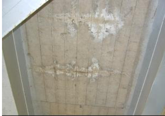
Figura 6-18 Eflorescencia debajo de la losa de concreto (Grado 3)
