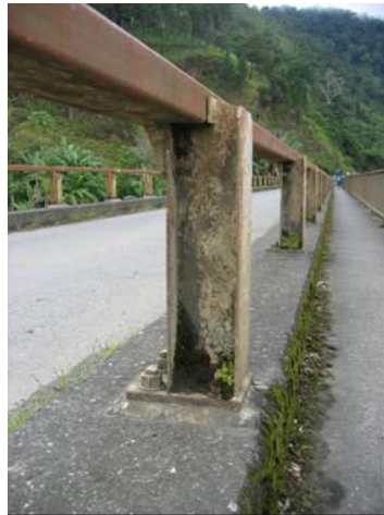
Figura 6-6 Oxidación (baranda de acero)
