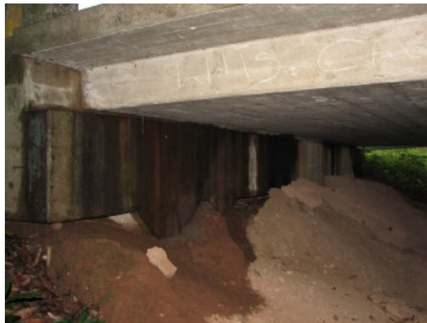
Figura 6-10 Filtración de agua por la junta de expansión (grado 5)
