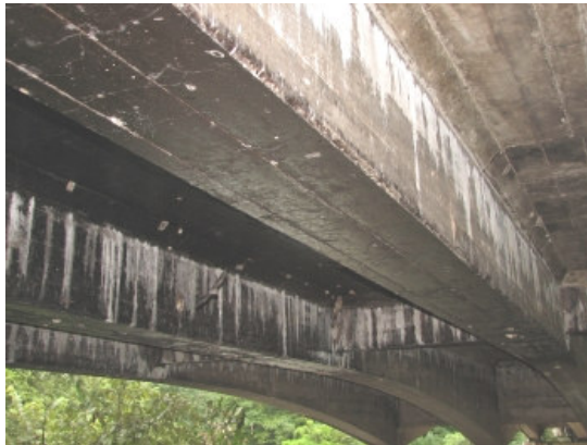
Figura 6-32 Eflorescencia en la viga principal (grado 4)
