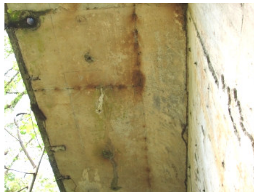
Figura 6-30 Oxidación en el acero de refuerzo.
