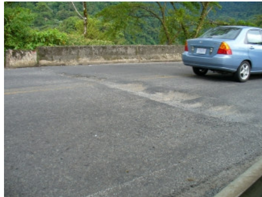
Figura 6-1 Ondulaciones en el pavimento
