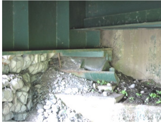
Figura 6-35 Deformación del apoyo (grado 5)
