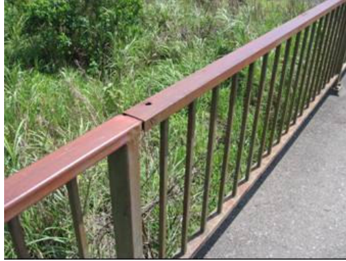
Figura 6-7 Corrosión en la baranda de acero (grado 3)
