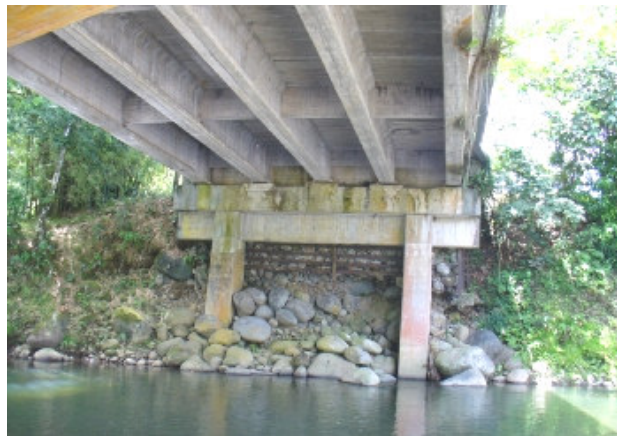
Figura 6-41 Colapso total de la protección del talud frente al bastión.
