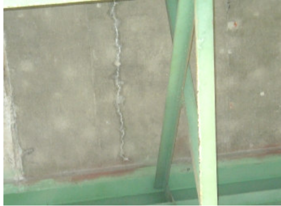
Figura 6-14 Grieta en una dirección en la losa
