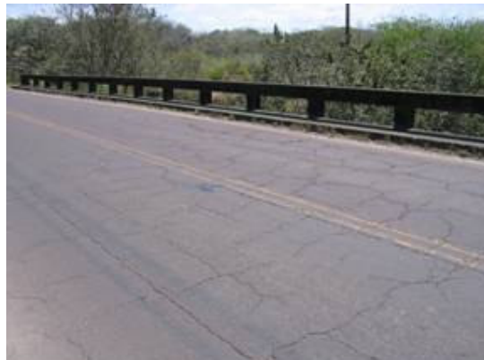
Figura 6-2 Grietas en el pavimento (grado 4)
