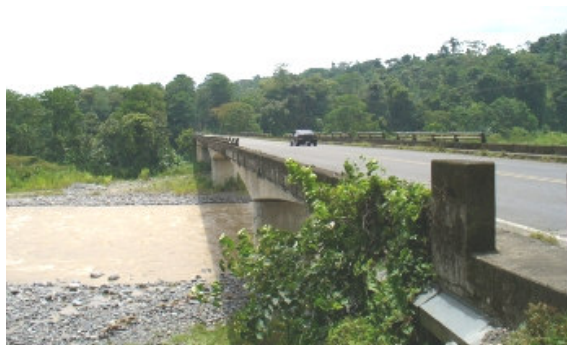
Figura 6-8 Falta baranda de acero (grado 5)
